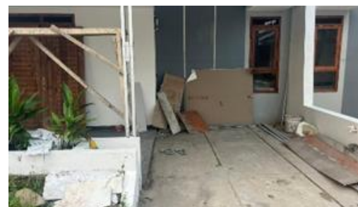
Gambar 1. Limbah pecahan bata dan sisa kayu bekisting di Perumahan Itera (Sumber : Dokumentasi Proyek, 2026)
