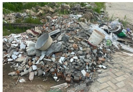
Gambar 2. Limbah pecahan bata dan sisa beton di Perumahan Sebiay (Sumber : Dokumentasi Proyek, 2026)
