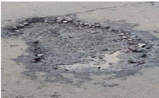
Gambar 6. Lubang (Sumber: Pemeliharaan Jalan Raya, 2007)
