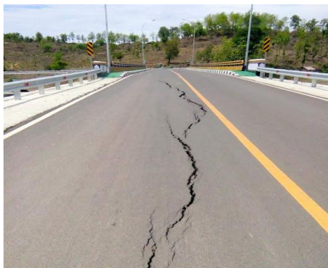
Gambar 7. Retak Memanjang (Sumber: Pemeliharaan Jalan Raya, 2007)
