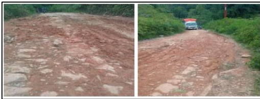
Gambar 1. Kondisi Jalan Eksisting
